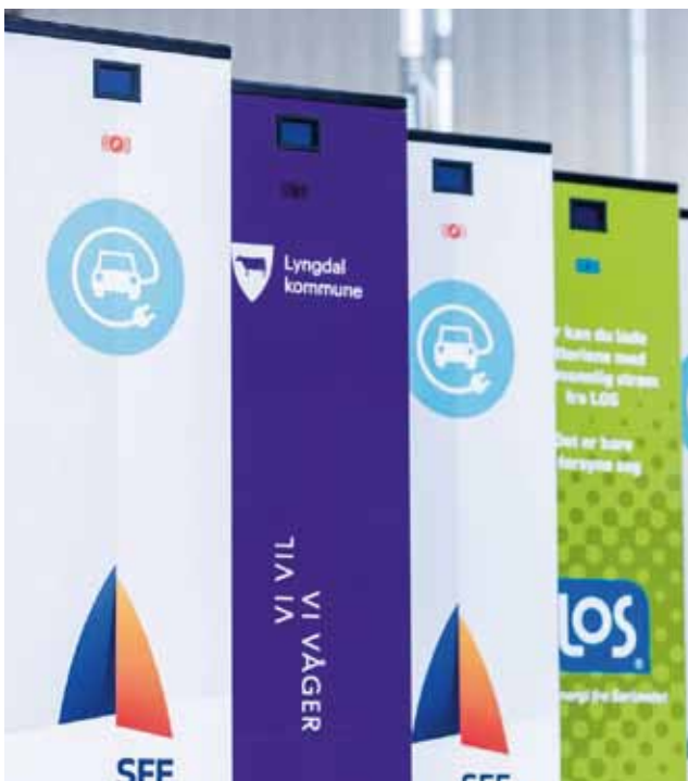
Rasante Entwicklung: Mehr Elektroautos und -transporter auf der Straße und staatliche Infrastruktur-Förderung beschleunigen die Nachfrage nach Elektroladesäulen der EBG compleo.
