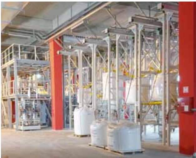
Fördern, Dosieren, Wiegen, Mischen und Abfüllen: Kitzmann entwickelt Anlagen und Verfahren für das Handling von Schüttgütern und Flüssigkeiten.
